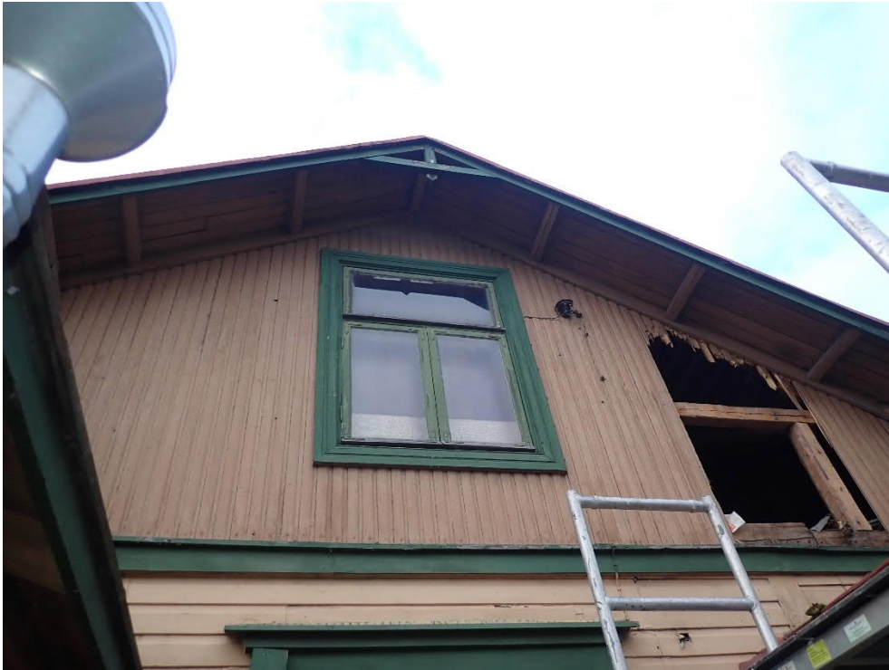
Kuva 18. Julkisivulaudoitusten ruskeasta ja vihreästä maalista kerätyissä näytteissä (RM2 ja RM3) havaittiin lyijyä ja sinkkiä vaarallisen jätteen raja-arvon ylittäviä määriä.
