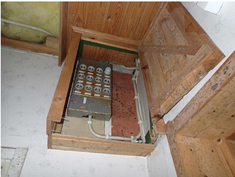
Kuva 4. Rakennuksen eteisten sähkökaappien yhteydessä asbestipahvia. Kuva eteisestä 2.
