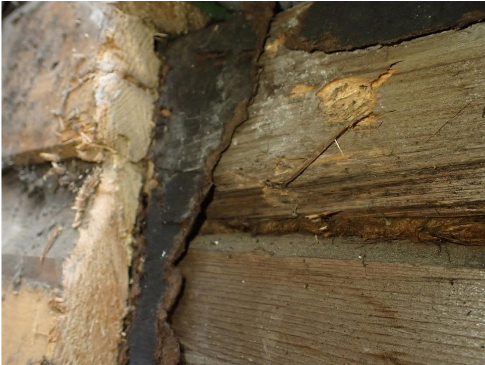
Kuva 16. Ulkoseinissä on asuinkerroksen osalla julkisivulaudoituksen takana tervapaperi, jonka PAH-pitoisuus ylittää vaarallisen jätteen raja-arvon.
