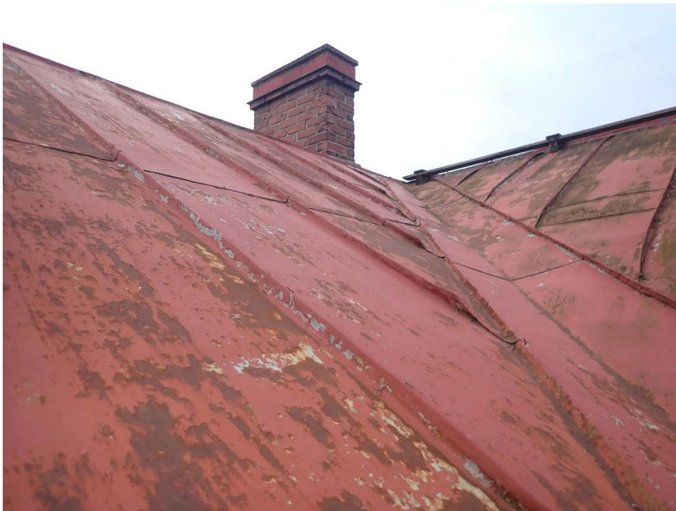
Kuva 17. Peltikaton maaleista kerätyssä näytteessä (RM1) havaittiin lyijyä ja sinkkiä vaarallisen jätteen raja-arvon ylittäviä määriä.
